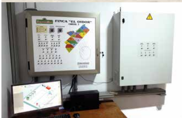
Cabezal de sistema de riego localizado de alta frecuencia. Permite realizar aportes precisos de nutrientes controlados por sistemas computacionales
